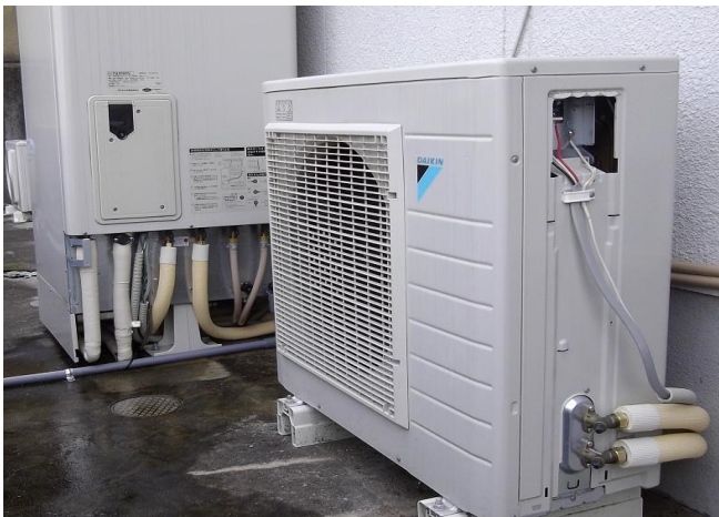
エコキュート・ヒートポンプ配管
