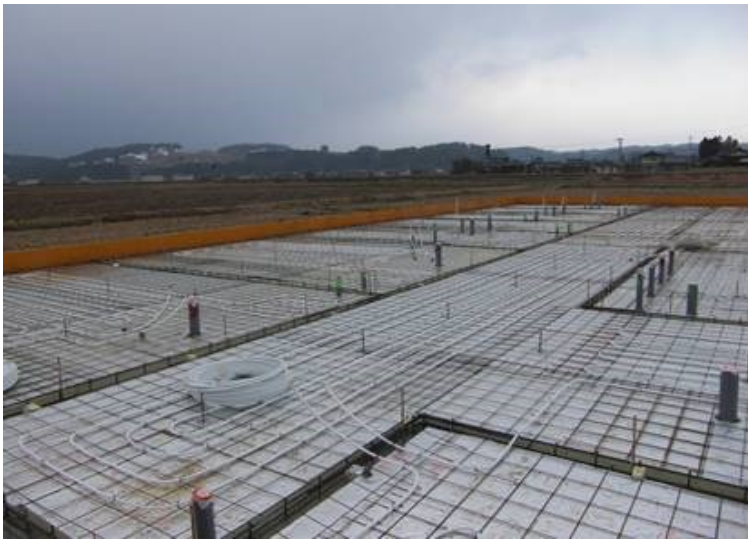
床暖房用配管
