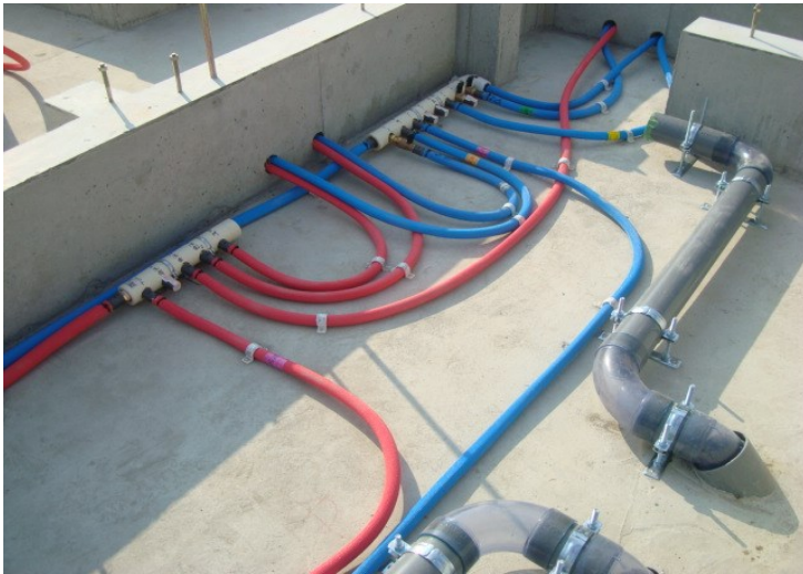
給水・給湯用配管(新築)
