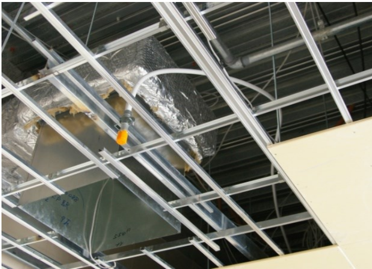
スプリンクラー配管
