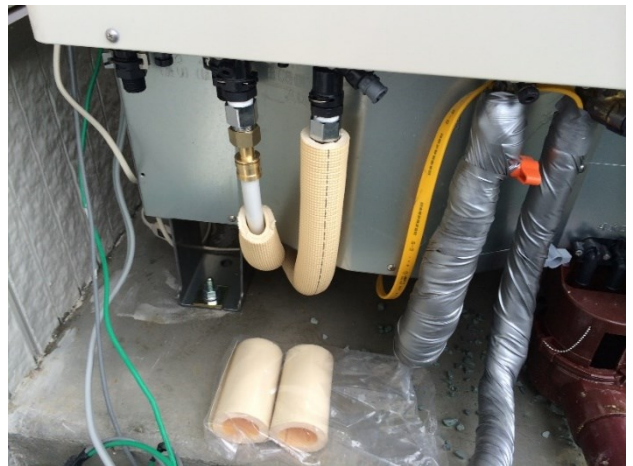
エコキュート・ヒートポンプ配管(耐震継手)
